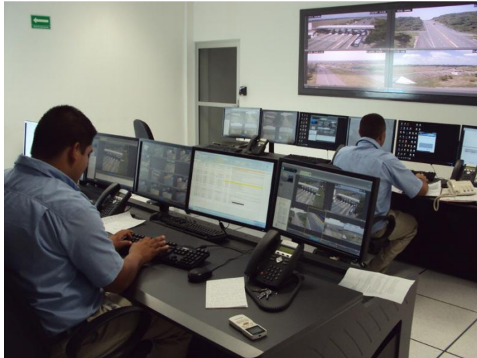
Centro de Control y Gestión de Tráfico
