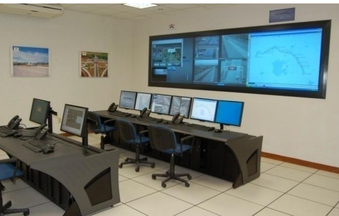
Centro de Control y Gestión de Tráfico
